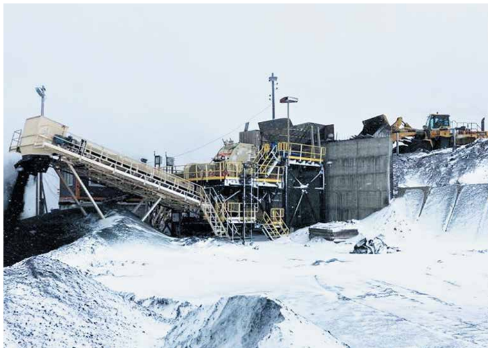
В ноябре-2021 на «Разрезууправлении «СУЭК-Кузбасс» введен в промышленную эксплуатацию новый дробильный комплекс Metso NP1313 производительностью 2 миллиона тонн в год
